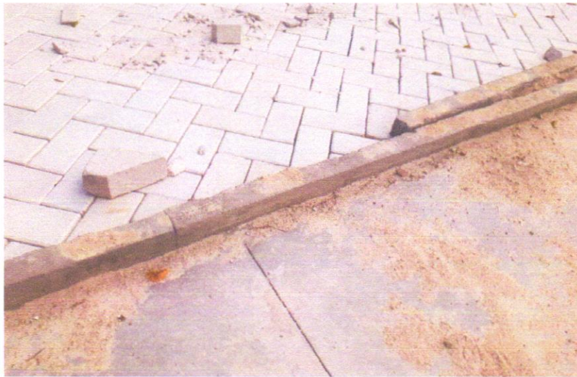
FOTO 05 – ASSENTAMENTO DE GUIA (MEIO-FIO) EM TRECHO RETO, CONFECCIONADA EM CONCRETO PRÉ-FABRICADO, DIMENSÕES 80X08X08X25 CM (COMPRIMENTO X BASE INFERIOR X BASE SUPERIOR X ALTURA), PARA URBANIZAÇÃO INTERNA DE EMPREENDIMENTOS. AF_06/2016
