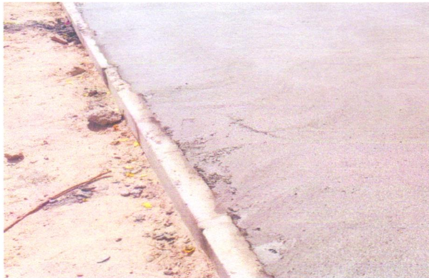
FOTO 07 – PAVIMENTAÇÃO EM CONCRETO, COM ESPESSURA DE 7 CM, COM ACABAMENTO FEITO UTILIZANDO ALISADORA DE CONCRETO (HELICOPTERO), INCLUIDO TELA DE AÇO SOLDADA NERVURADA CA60, Q196 (3,11 KG/M 2 ), DIAMETRO DO FIO 5.0 MM, LARGURA = 2,45 M, ESPAÇAMENTO DA MALHA = 10 X 10 CM, JUNTA DE DILATAÇÃO EM PVC A CADA 2,00 M, CONCRETO FCK = 20 MPA
