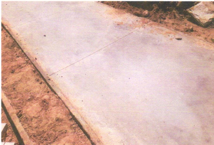
FOTO 07 – PISO EM CONCRETO FCK = 20 MPA, PREPARO MECÂNICO, ESPESSURA 7 CM, COM ARMAÇÃO EM TELA SOLDADA
