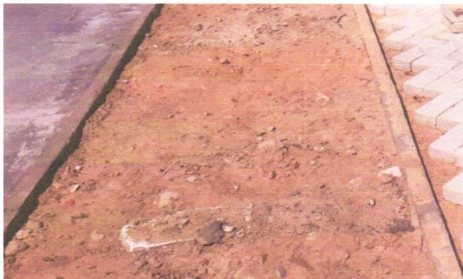
FOTO 03 - REATERRO MANUAL COM COMPACTAÇÃO MECANIZADA EM CAMADAS DE 0,20 M NO MÁXIMO, COM MATERIAL DA PRÓPRIA OBRA
